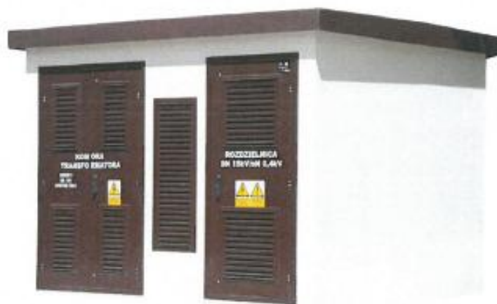
Rysunek 6. Przykładowa kontenerowa stacja transformatorowa.
