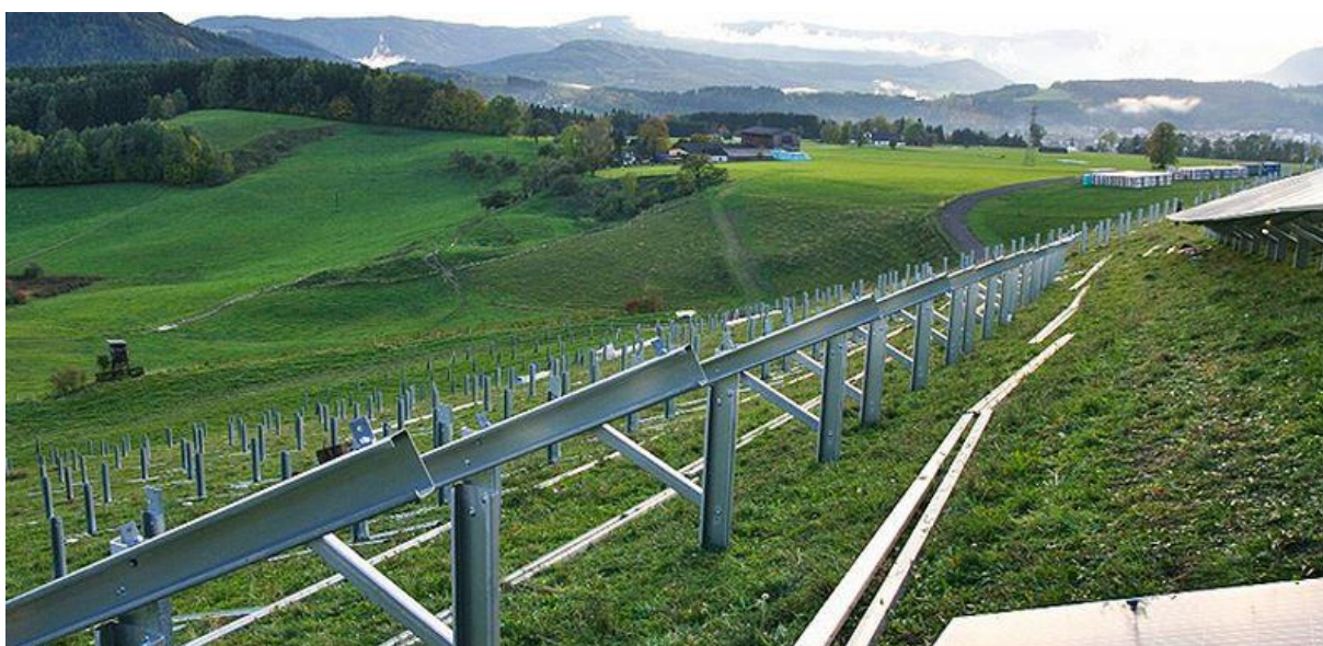
Zdjęcie 3. Konstrukcja przeznaczona do posadowienia paneli fotowoltaicznych.
