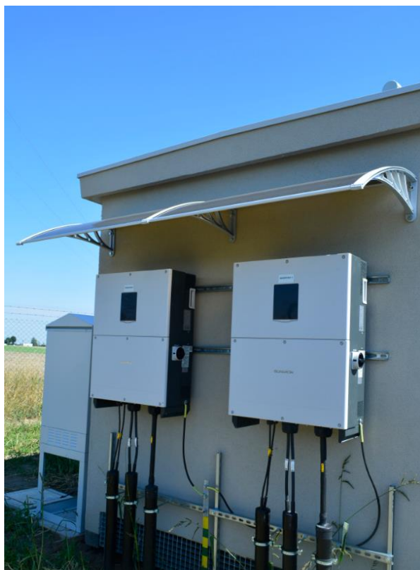
FOTOGRAFIA 4. Widok na przykładowe inwertery, zamontowane na stacji transformatorowej, farma w miejscowości Olszanka (woj. opolskie) foto: Paweł Kręciproch
