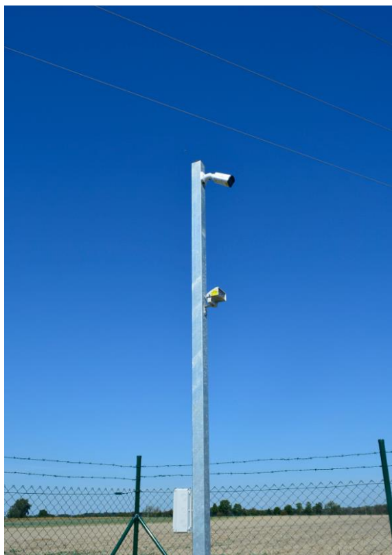
FOTOGRAFIA 5. Widok na zastosowany przykładowy system monitoringu na terenie farmy, farma w miejscowości Olszanka (woj. opolskie) foto: Paweł Kręciproch
