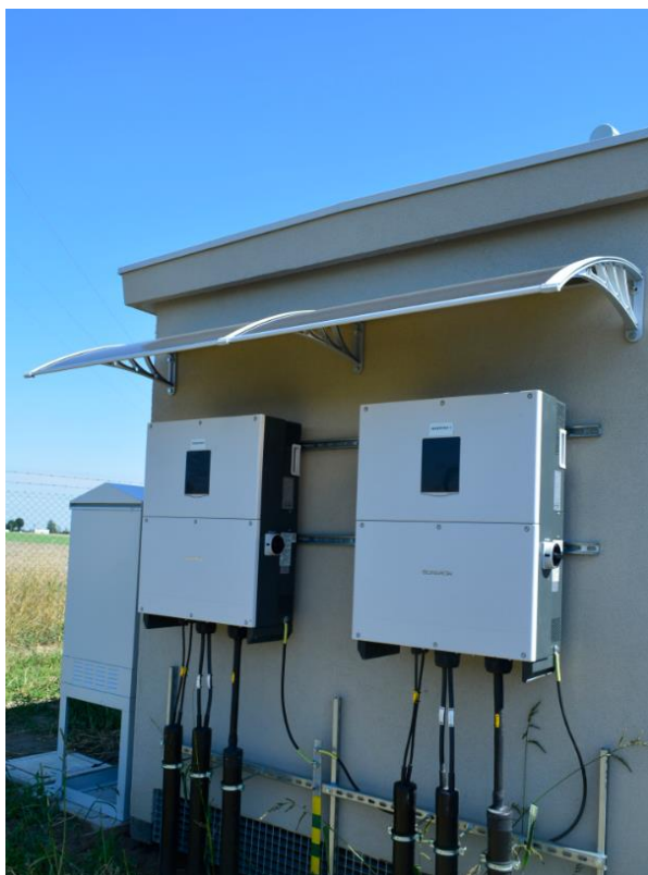
Fot. 2. Widok na przykładowe inwertery, zamontowane na stacji transformatorowej, farma w miejscowości Olszanka (woj. opolskie) foto: Paweł Kręciproch
