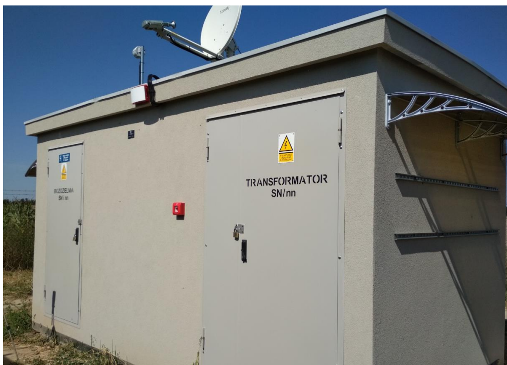
Fot. 4. Przykładowa stacja transformatorowa z urządzeniami sterującymi i monitorującymi, towarzysząca instalacji fotowoltaicznej w miejscowości Olszanka (woj. opolskie) [fot. Paweł Kręciproch]
