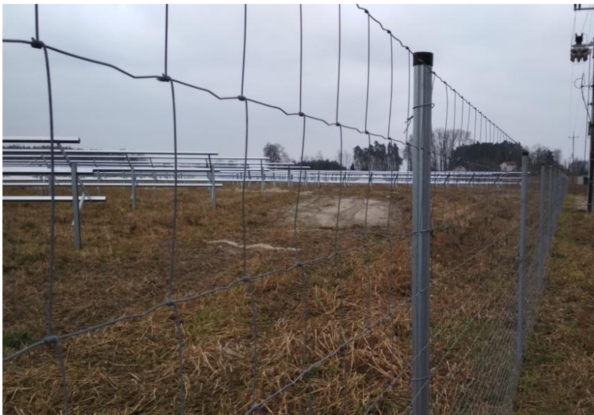
Fot. 5. Widok na przykładowe ogrodzenie dla instalacji, o ustalonej szerokości oczek w siatce [foto: Paweł Kręciproch; instalacja w rejonie miejscowości Poddębice – woj. łódzkie]
